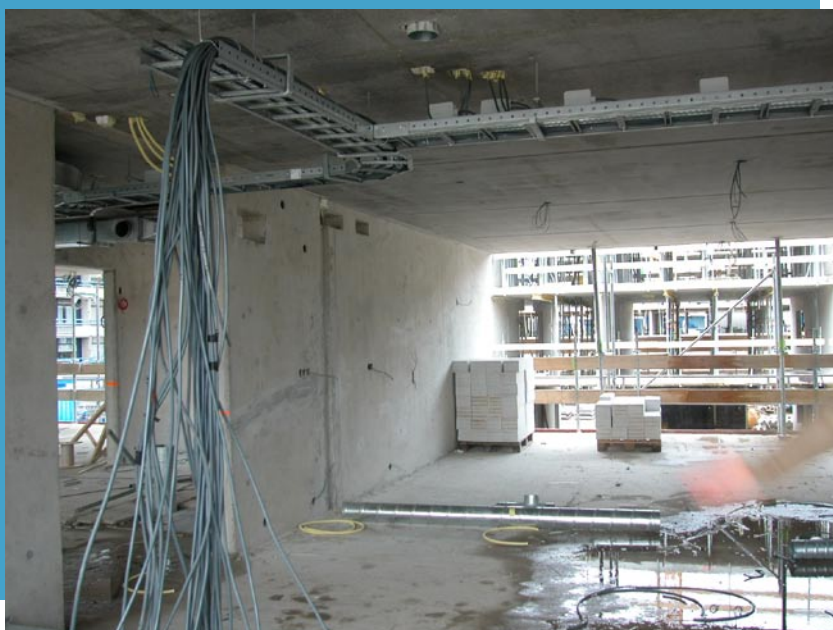
Figuur 16 In het Leo Polakhuis is een enorme hoeveelheid kabels verwerkt voor het domotica systeem
